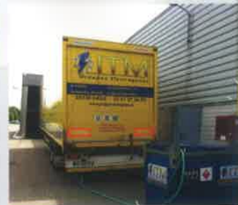
Groupe électrogène + cuve additio
