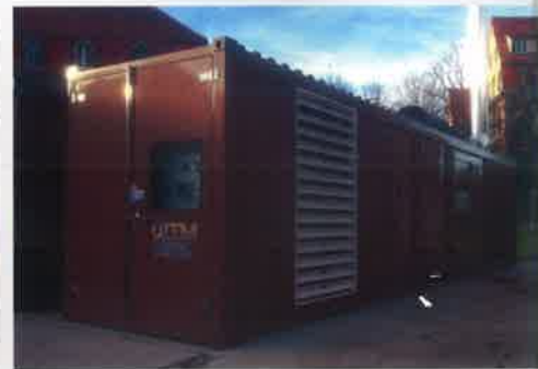
Centre hospitalier de ROUFFACH (68) -1550 kVA
