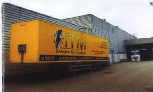
Groupe électrogène 1250 kVA installé dans une semi-remorque
